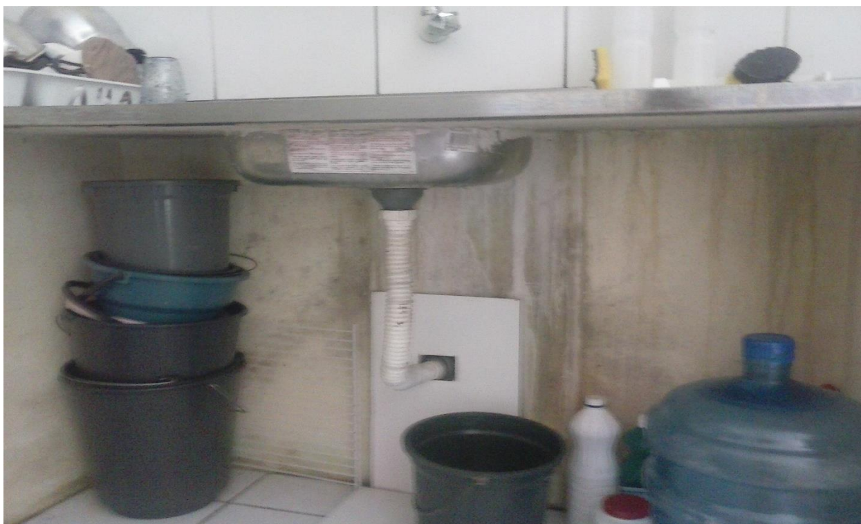
Reg. fotográfico da situação-Engenharia e Fiscalização/SEMUSB/PMB
