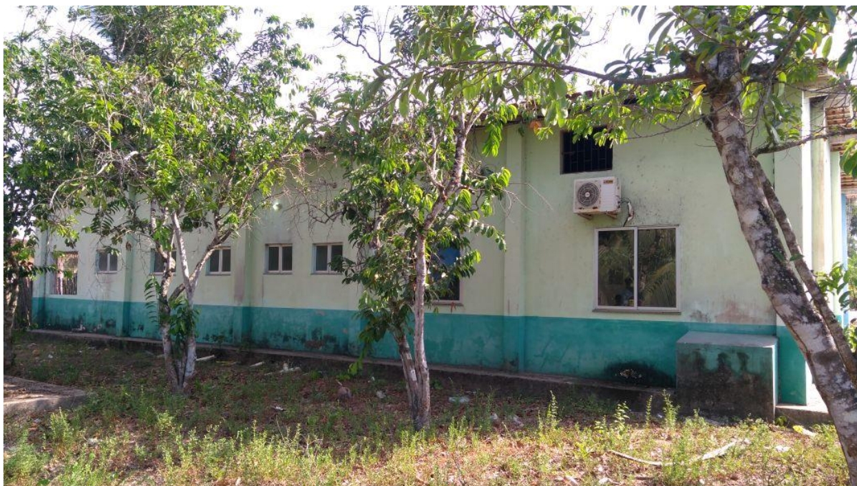
Reg. fotográfico da situação-Engenharia e Fiscalização/SEMUSB/PMB
