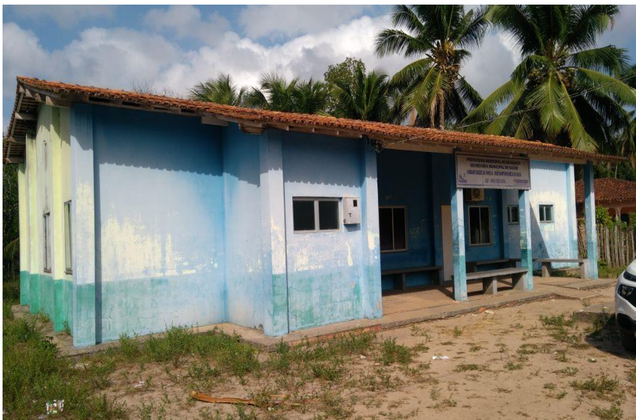
Reg. fotográfico da situação-Engenharia e Fiscalização/SEMUSB/PMB
