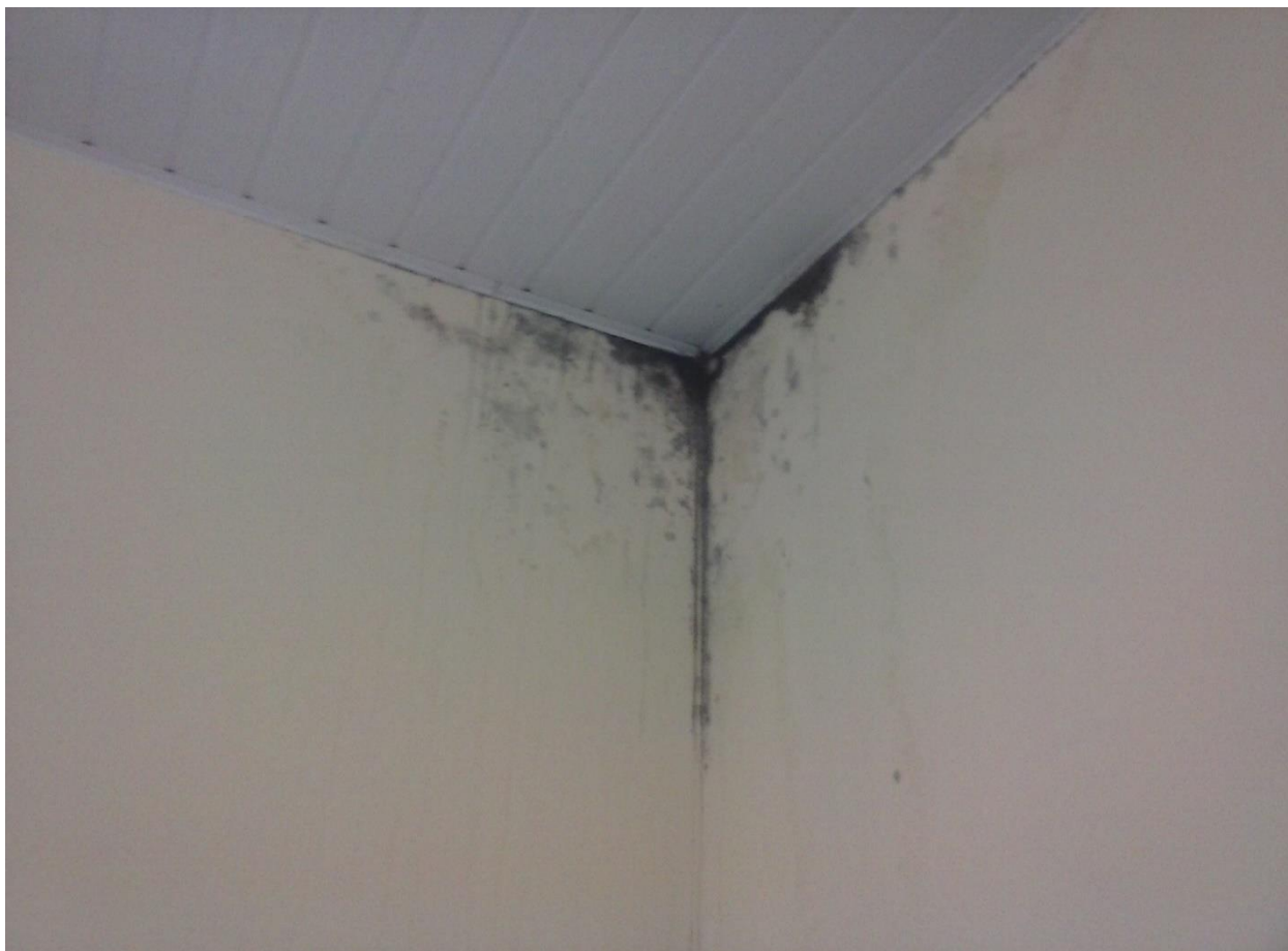
Reg. fotográfico da situação-Engenharia e Fiscalização/SEMUSB/PMB
