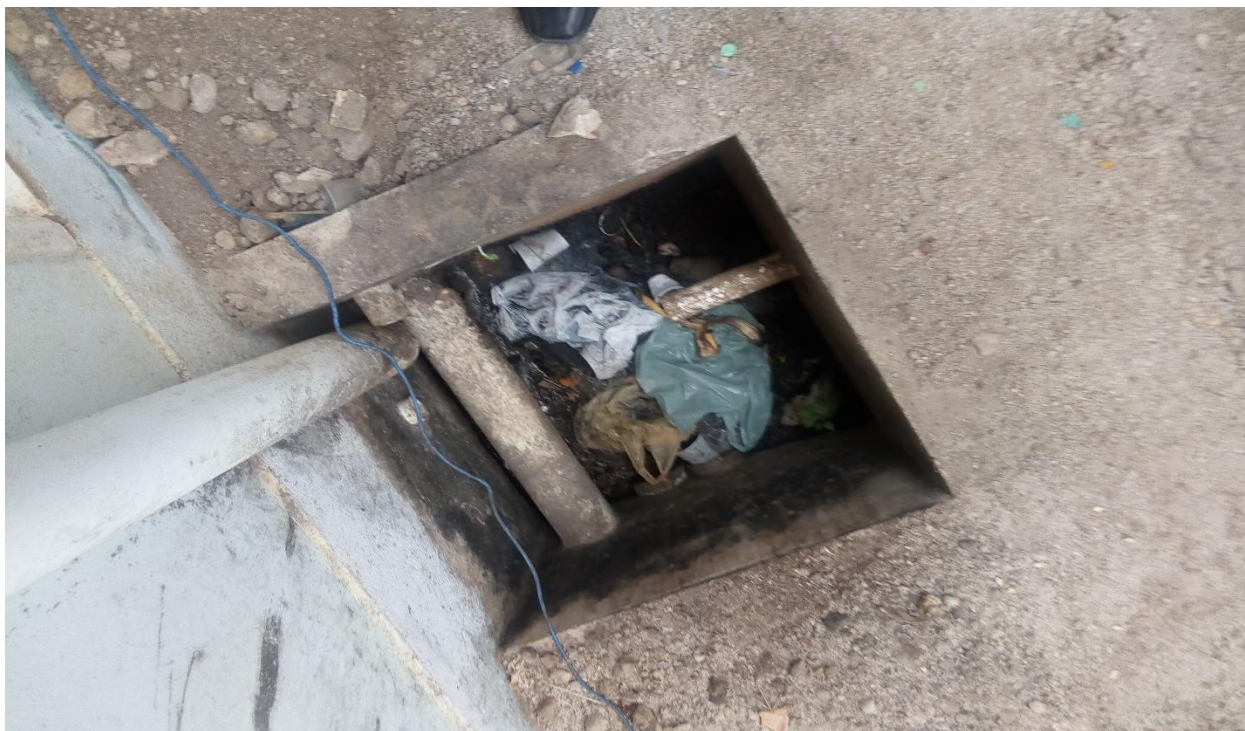
Reg. fotográfico da situação-Engenharia e Fiscalização/SEMUSB/PMB
