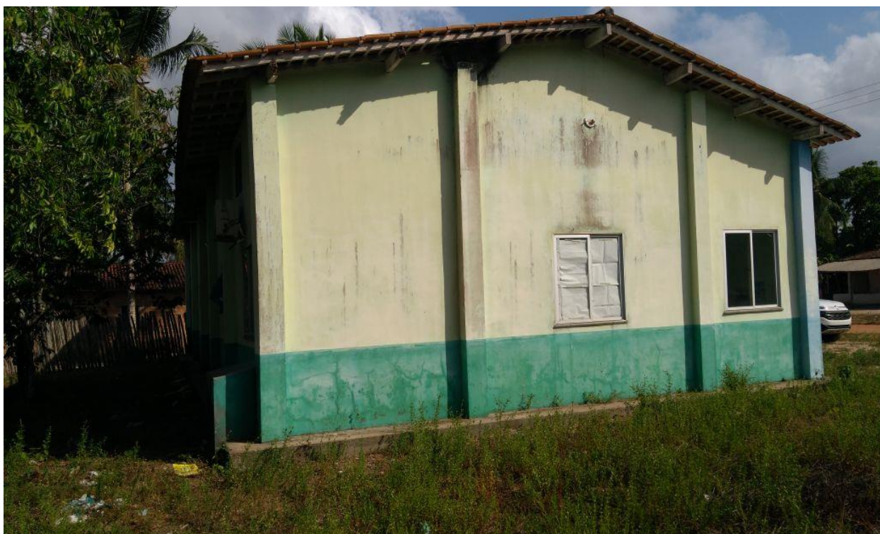
Reg. fotográfico da situação-Engenharia e Fiscalização/SEMUSB/PMB
