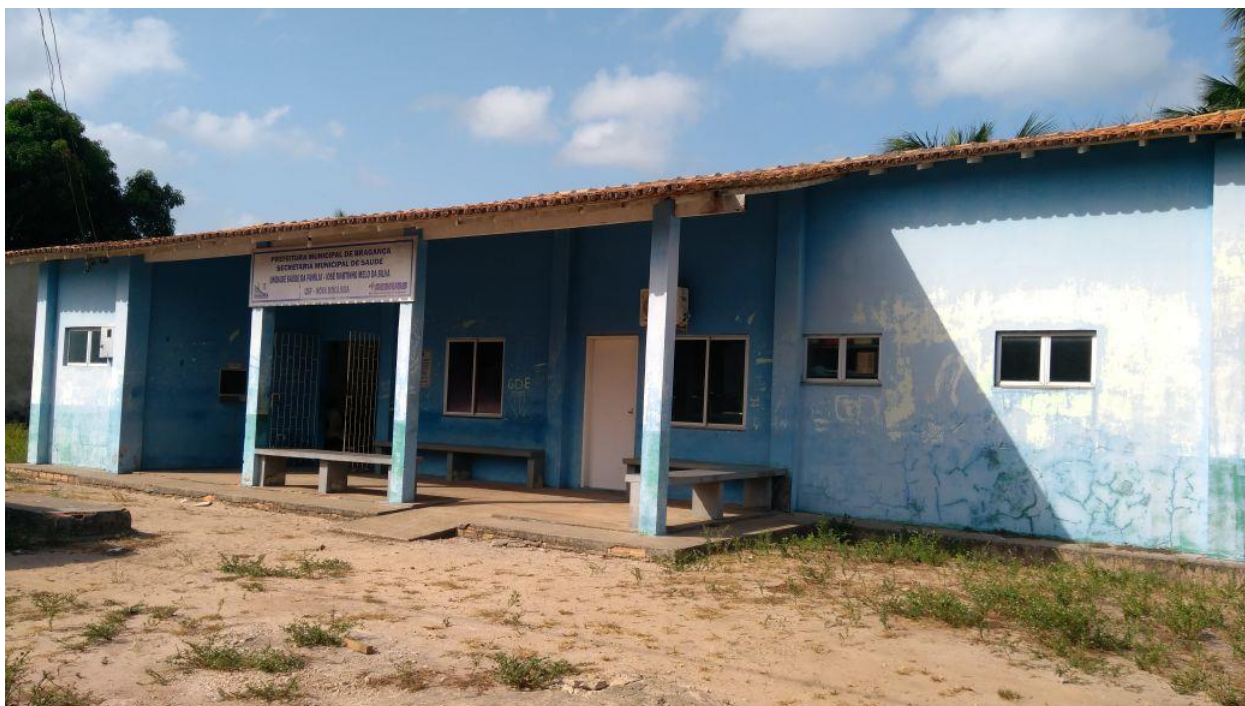
Reg. fotográfico da situação-Engenharia e Fiscalização/SEMUSB/PMB
